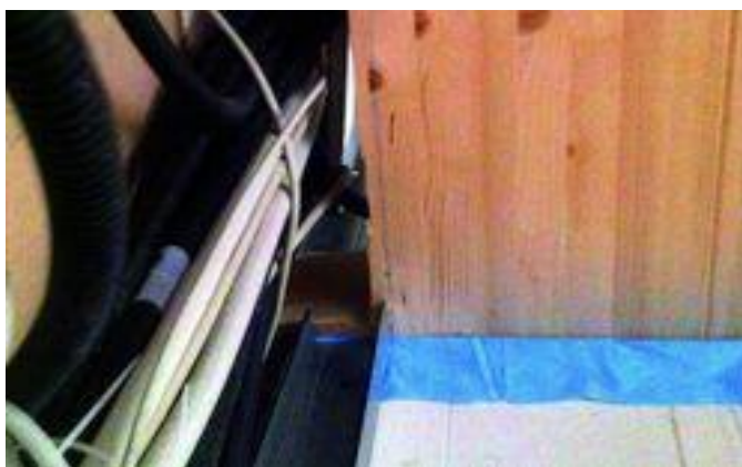
Der Brandschutzschott verläuft nicht fachgerecht in der Deckenebene und wird von Kabeln in Leerrohren umgeben. (Foto: Stefan Winter)
